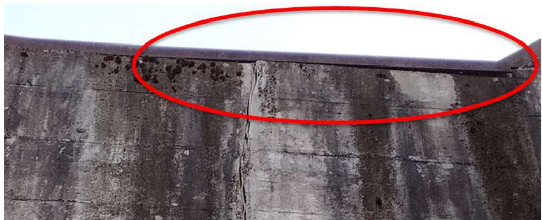
Abbildung 23: Blick von unterhalb auf Riss Nr. 2. Beim Stahl- profil ist erkennbar, dass die beiden Mauerteile nicht mehr fluchten. Quelle: Flussbau AG SAH
