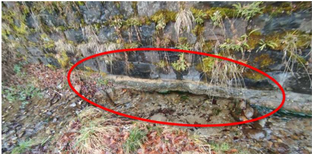
Abbildung 29: Blick auf die linksufrige unterspülte Ufermauer (Fliessrichtung von links nach rechts). Quelle: Flussbau AG SAH.
