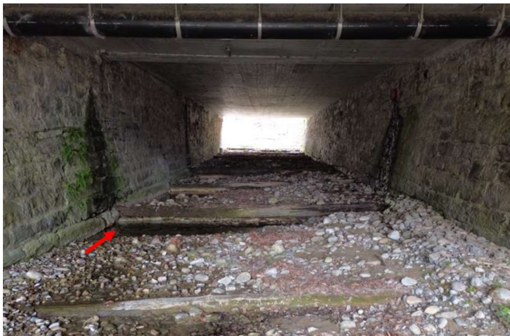
Abbildung 31: Blick gegen die Fliess- richtung im Durchlass Blochstrasse. Die Rund- hölzer sind teilweise unter- spült (roter Pfeil). Quelle: Flussbau AG SAH.
