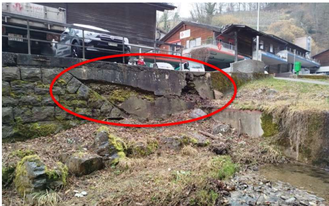
Abbildung 27: Schadstellen rechtsufrig unterhalb des Fussgänger- steiges (Blick gegen die Fliessrichtung). Quelle: Flussbau AG SAH.
