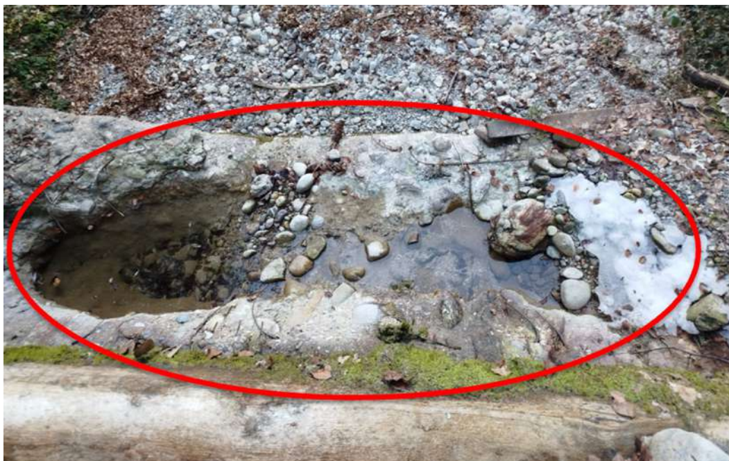
Abbildung 20: Schadstelle an der Sperre 15 (Blick in Fliess- richtung). Quelle: Fluss- bau AG SAH.
