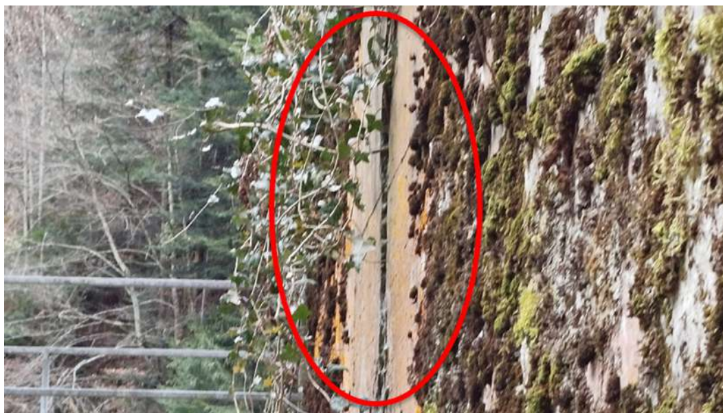
Abbildung 24: Blick auf Riss Nr. 3 von der Oberwasserseite ent- lang der Mauerflucht. Auch hier ist erkennbar, dass die beiden Mauer- teile nicht mehr fluchten. Quelle: Flussbau AG SAH
