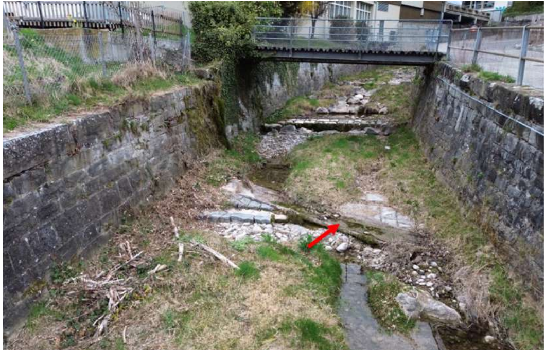
Abbildung 35: Ein unbekannter Beton- streifen quert die Sohle. Blick gegen die Fliess- richtung. Quelle: Fluss- bau AG SAH.
