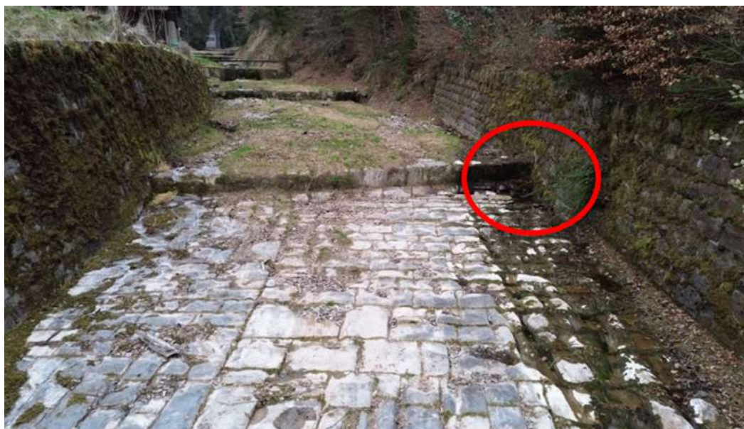
Abbildung 30: Blick gegen die Fliess- richtung auf die Pfläste- rung. Der Schaden ist im roten Kreis gekennzeichnet. Quelle: Flussbau AG SAH.
