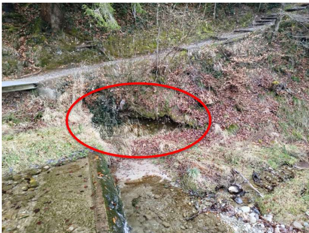
Abbildung 28: Unterspülung der linksufrigen Ufermauer unterhalb des Fussgän- gersteiges. Quelle: Fluss- bau AG SAH.
